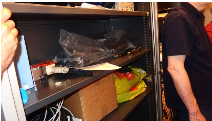
De kast met bruikbare spullen in de serverruimte
