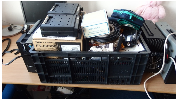
Dit kratje werd in de kast geplaatst in de serverruimte
